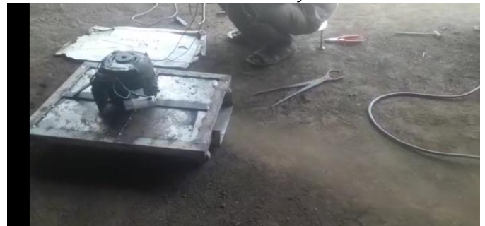
Fig: Actual working suction
